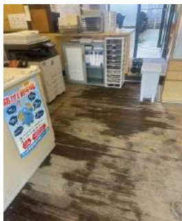
赤間駅前冠水による、床上浸水
